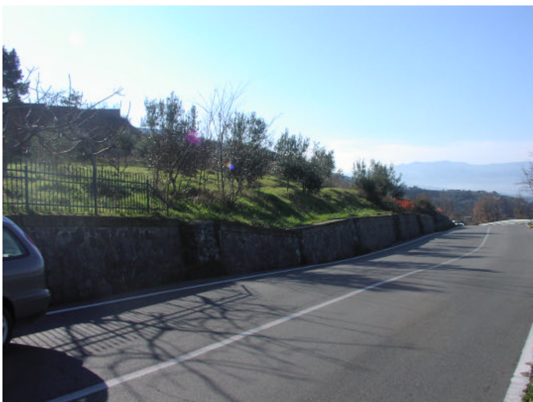
Fot.3 SP 248 che attraversa la frana.
