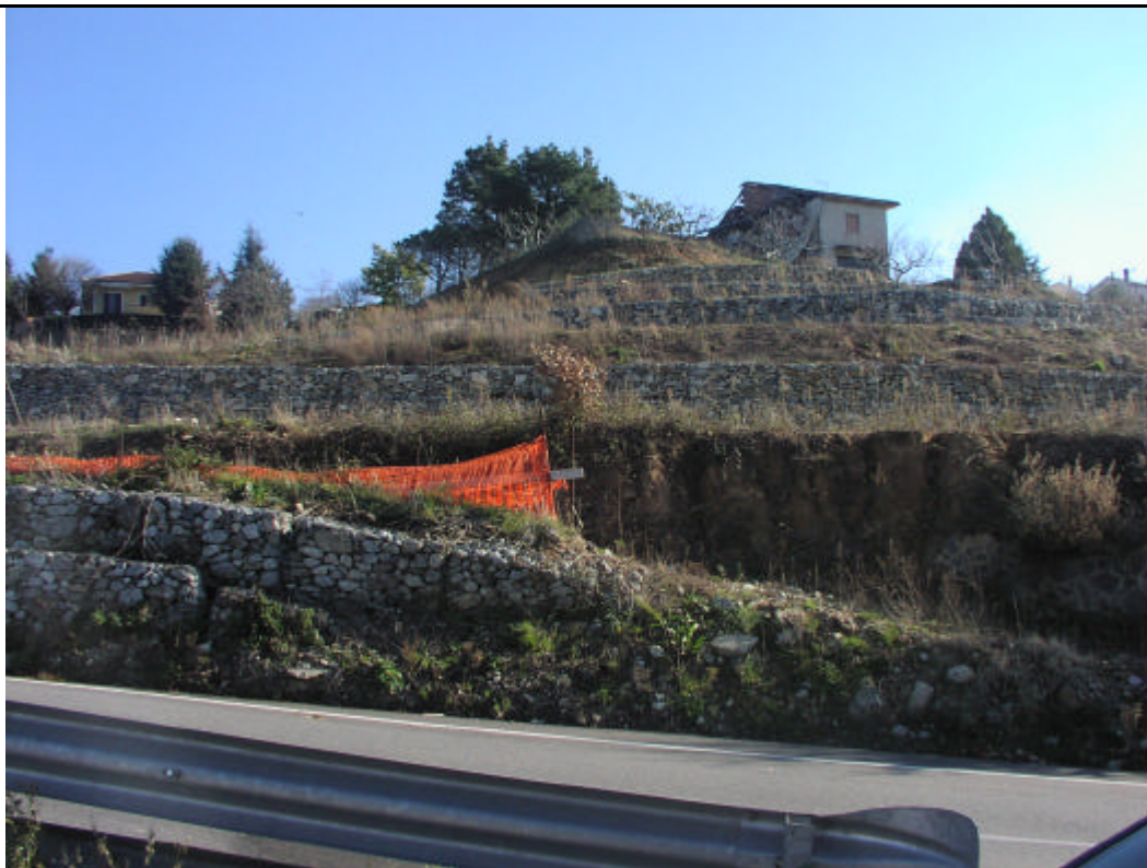
Fot.2 Area in frana - Sistemazione con gabbionate. E' visibile l'edificio in parte crollato.
